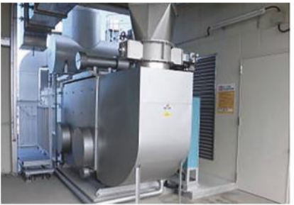
群馬製造所 废热回收锅炉
