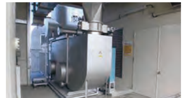
群馬製造所 排熱ボイラー
