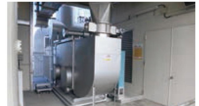
群马制造所 余热锅炉
