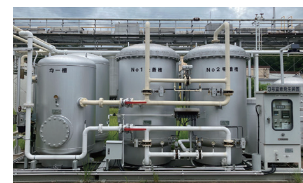
節電イベントで電力使用量が削減した窒素発生装置
