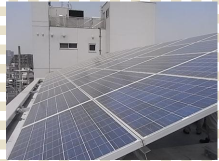
太陽電池モジュール (八尾製造所)
