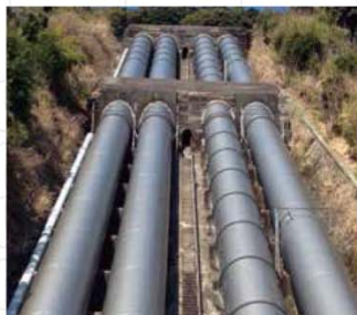
日本轻金属株式会社蒲原制造所的发电站用水压铁管
